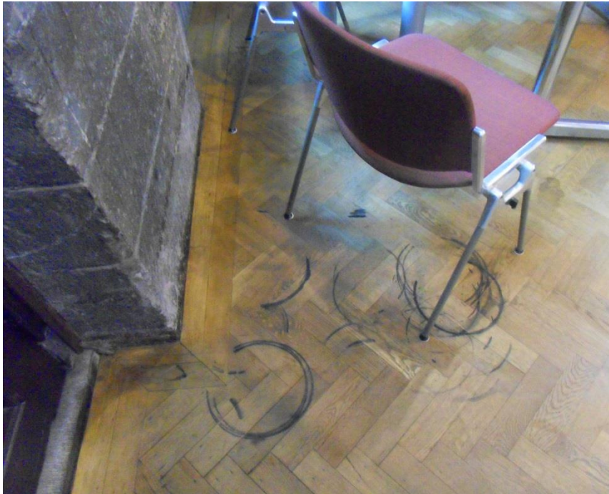
Afb. 17: zwarte kringen in de eiken parketvloer als gevolg van de reactie tussen een metalen vuilnisemmer, vocht en het in eikenhout aanwezige looizuur. Schade had voorkomen kunnen worden door het dweilen te beperken, een bescherming onder de vuilnisemmer te plaatsen of een kunststof vuilnisemmer te gebruiken.
