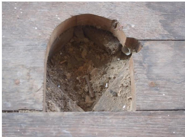
Afb.23: schade in plankenvloer door onzorgvuldig, op destructieve wijze treffen van voorzieningen.
