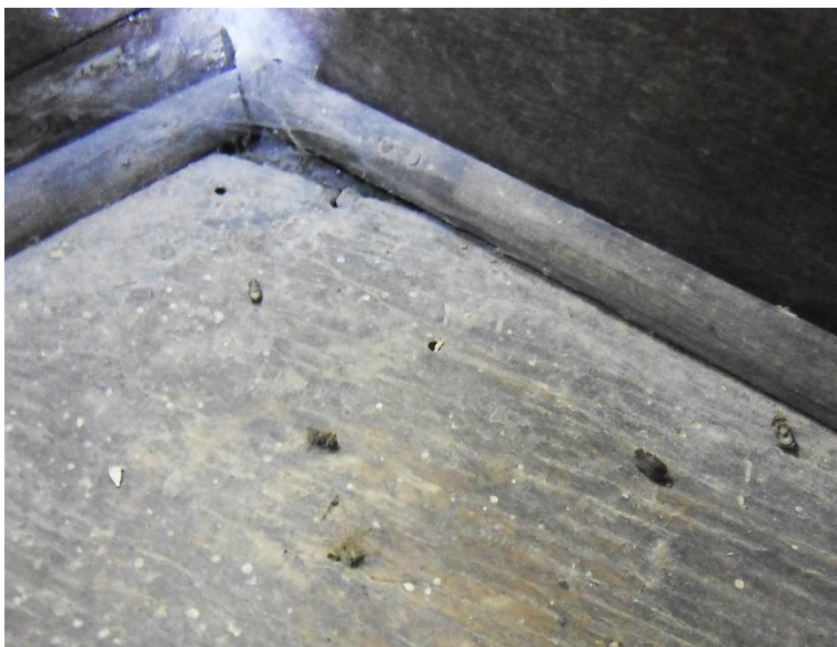
Afb. 12: detail van een plankenvloer met aan weerszijden een houten lambrisering. In de vloer zijn uitvliegopeningen zichtbaar van de spinhoutkevers. Enkele exemplaren zijn dood aangetroffen.
