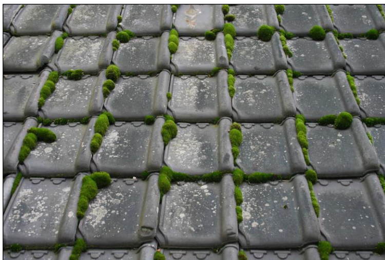
Bij flauwer hellende dakvlakken blijft veel water lang in de zijsluiting hangen, waardoor afvoer van regenwater stagneert en sterke groei van kussentjesmos ontstaat. Tijdig verwijderen voorkomt lekkages.
