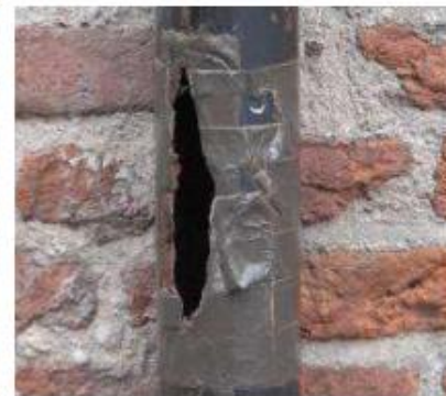
Kapotte delen van de hemelwaterafvoer met hetzelfde materiaal vervangen: vergunningvrij
