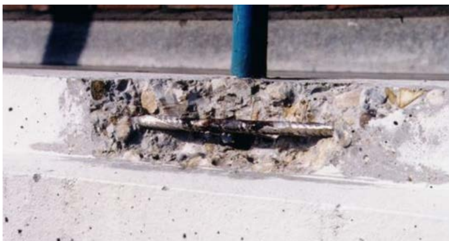
Constructieve schade in een betonnen ondergrond.
