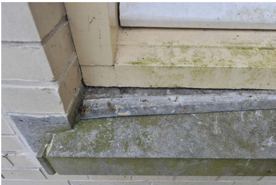
Hier is de loodslabbe tussen kozijndorpel en stenen weldorpel te smal en bevestigd met (inmiddels roestende ) spijkers. Bevestiging met latten had een beter resultaat geleverd.
