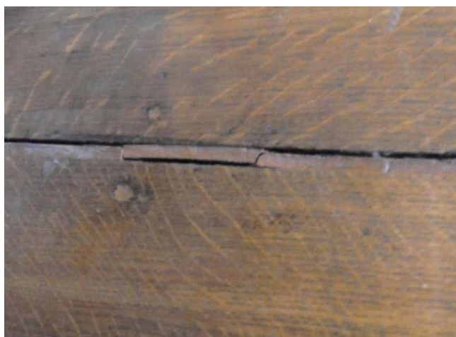
Afb.26: Losgekomen 'uitgedroogd' vulmiddel tussen twee vloerplanken.
